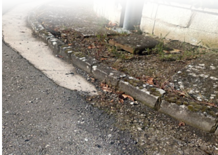
Arqueta descubierta y acera sin baldosas en la intersección de las calles Medina Azahara y Medina de Rioseco
